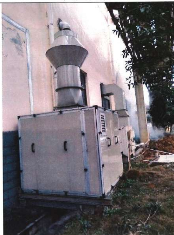
无组织废气处理设施
